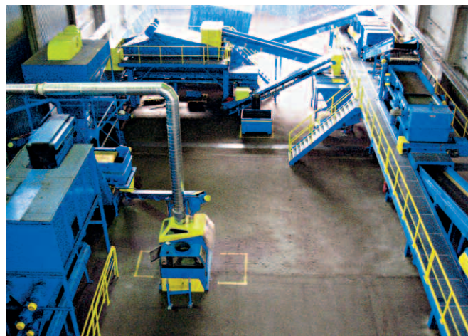
Pioniertat: Teilansicht der RESH-Pilotanlage in der Ferro Wohlen.
